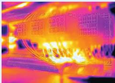
Wärmebild eines Hot Spots im Schaltschrank
