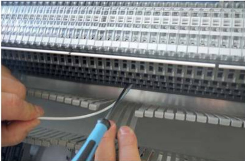
Im Vergleich: Montageplatte - Behinderung durch Kabelkanal
