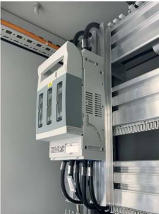
Abb. 1: Hauptschalter auf RG035.
